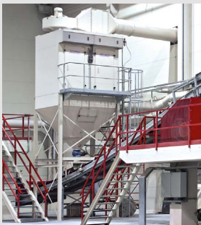
HKD III - Dedusting system HKD III - Entstaubungsanlage
