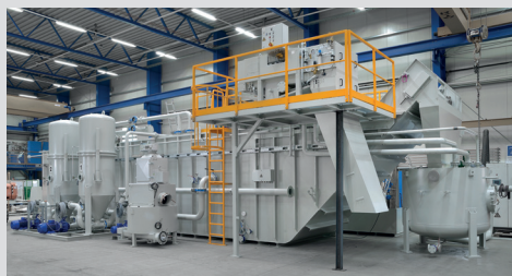
Precoat filter plant ASAV34,0 with sedimentation tank / Anschwemmfilteranlage ASAV34,0 2-fach mit Sedimentationsbecken
